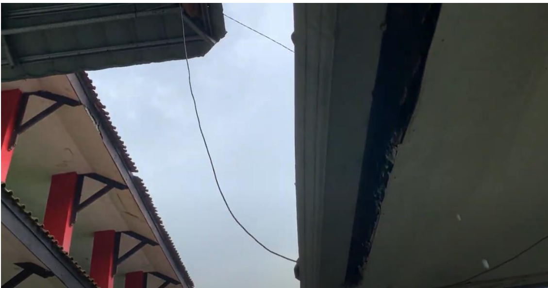
Gambar 3.4 Kabel LAN penghubung antar router dari server ke router di setiap kelas
